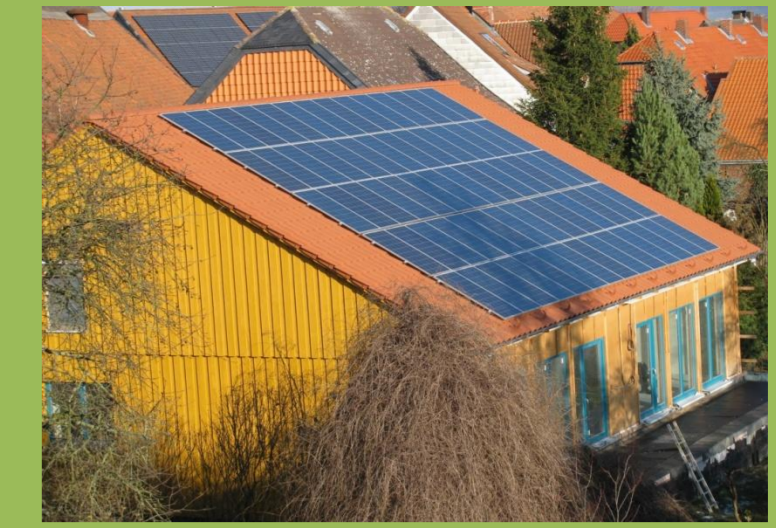
Photovoltaikanlage auf unserem Schulgebäude
